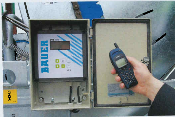
Moderne Anlage mit Computer-Steuerung: Über ein GSM-Modul lässt sich die Maschine per SMS steuern und überwachen.
